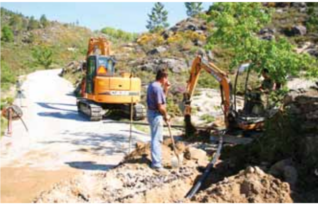
Castro Laboreiro (abastecimento de água)
