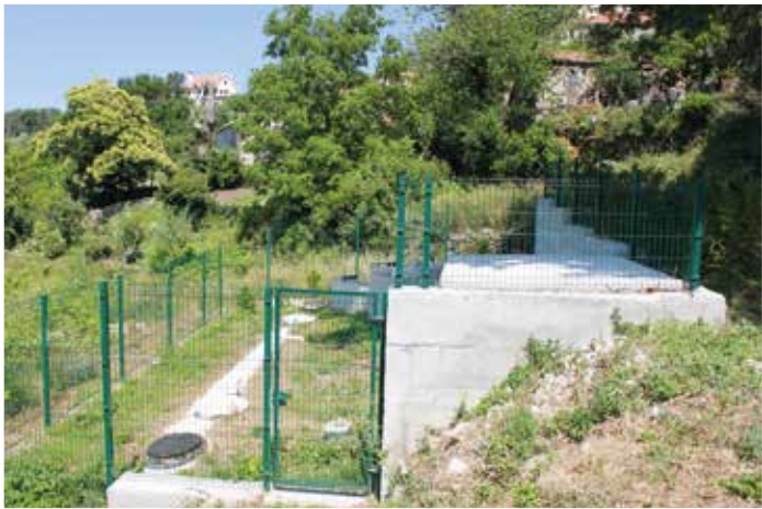
Rede de saneamento - Couso
