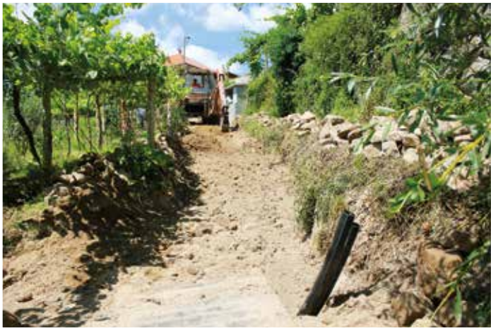
Rede de Saneamento
