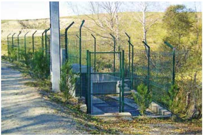
Rede de saneamento
