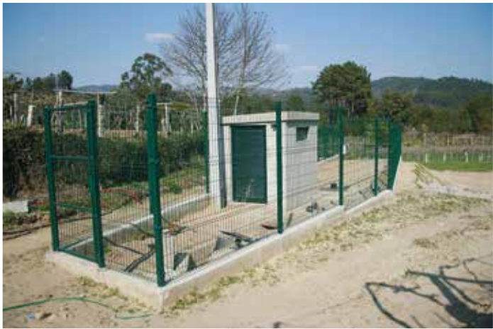
Rede de saneamento
