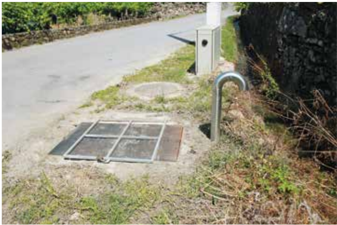
Rede de saneamento
