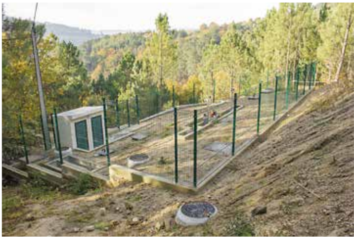
Rede de saneamento
