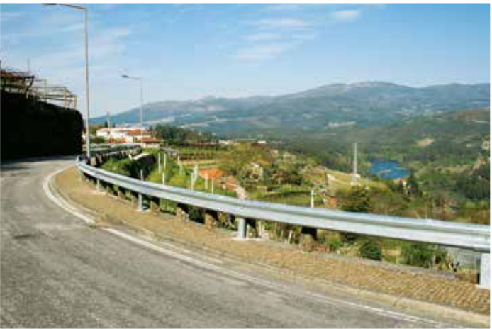
Rails de protecção (Assadura)
