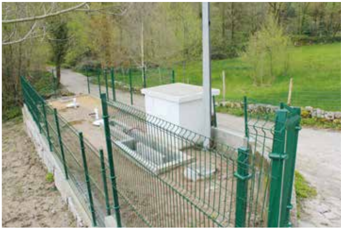
Rede de saneamento
