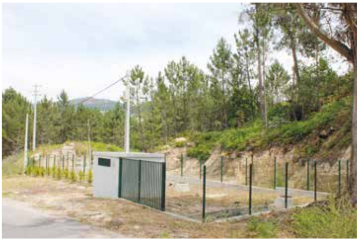
Rede de saneamento
