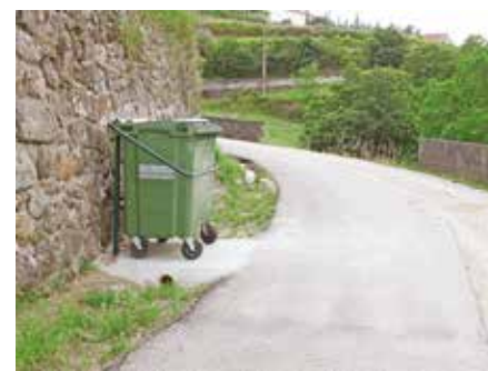
Viladraque – colocação de vários suportes de contentores
