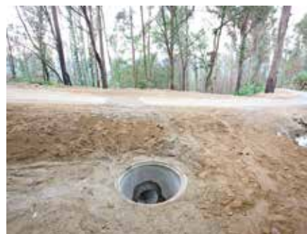
Viladraque – desvio de águas fluviais
