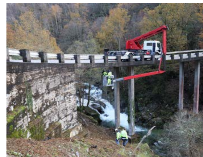
Parada do Monte | estudo de diagnóstico da deformação do tabuleiro e caracterização geométrica da ponte da minhoteira
